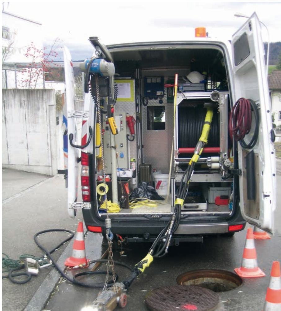
Fig. 2 Outre les canalisations publiques, les installations privées d'évacuation des eaux devront à l'avenir aussi être systématiquement contrôlées et réhabilitées.
