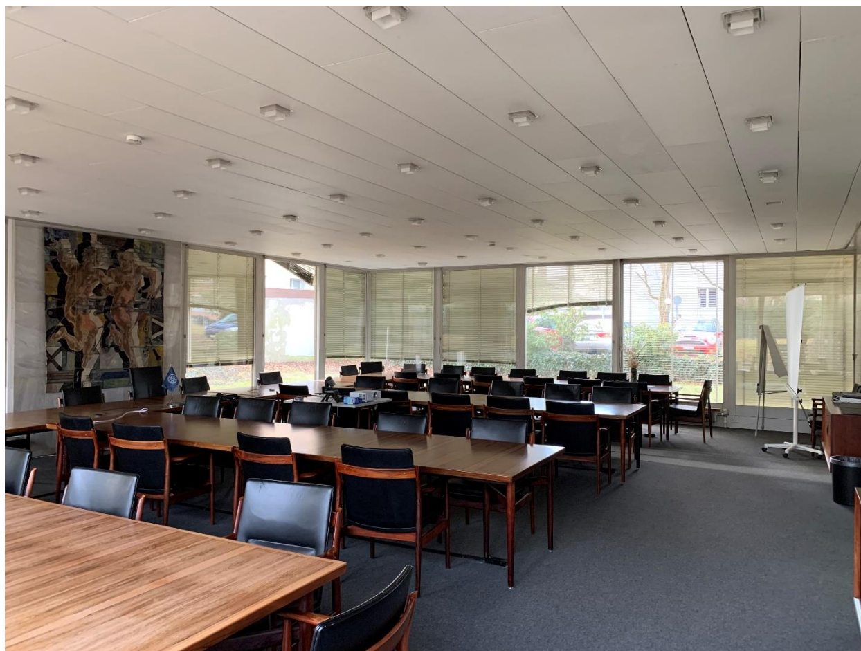
Fig. 10 : Salle de conférence existante avec pare-soleil défectueux et dégâts dus à l'humidité sur les fenêtres en bois
