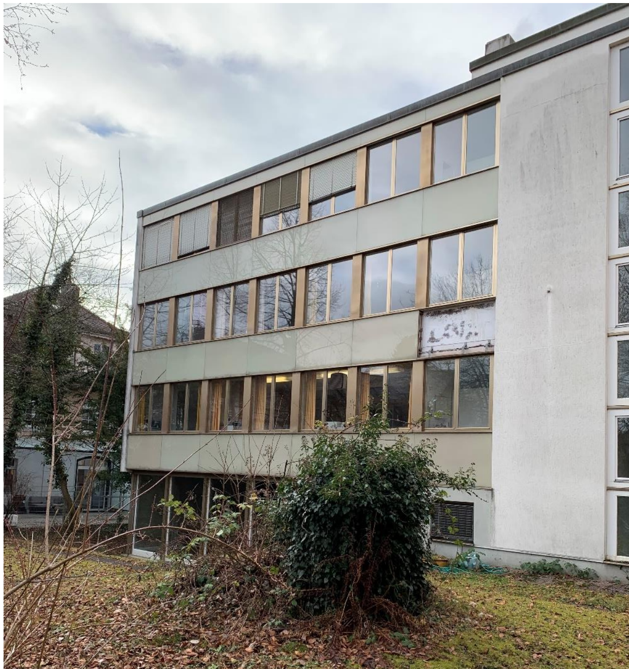
Fig. 09 : Revêtement manquant sur la façade nord-est
