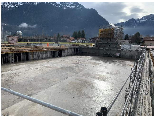
Illustration 1 : dalle de fondation bombée Illustration 2 : dalle de fondation inondée
