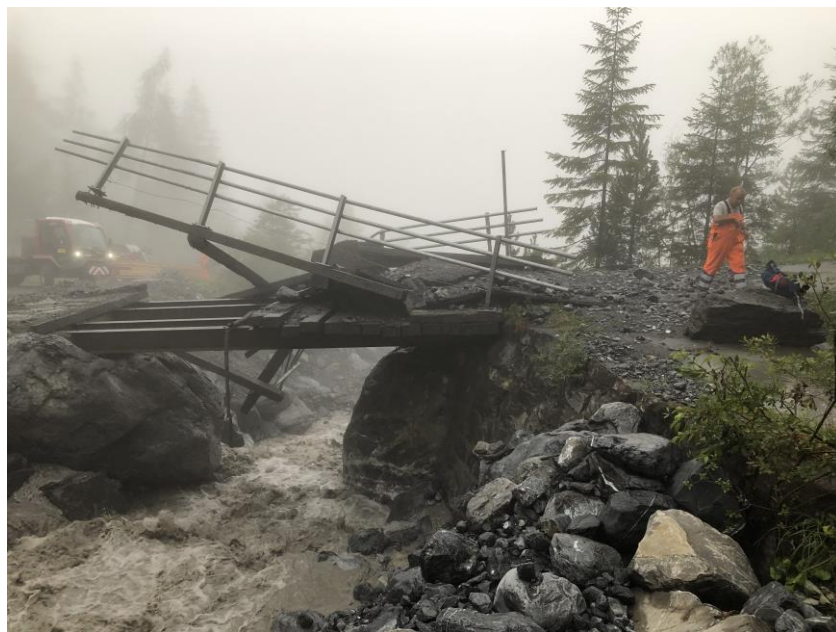
Abbildung 8 Durch den Murgang vom August 2019 zerstörte Rinderstutz-Brücke auf der Zufahrtsstrasse zum Oeschinensee (Foto: Abteilung Naturgefahren).
