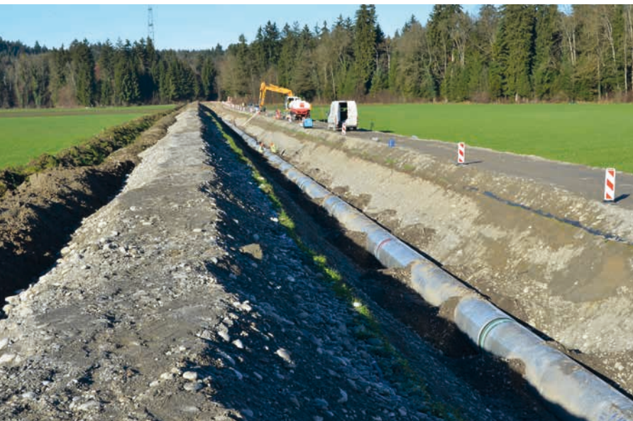
Fig. 2 En équipant de nouveaux sites de captages d'eau et en construisant quelques kilomètres de nouvelles conduites, la WVRB peut désaffecter d'anciennes prises d'eau de source et des conduites de transport d'une longueur totale de 37 kilomètres, qui auraient toutes dû être réhabilitées ces prochaines années. Photo : Conduite de transport reliant le captage Amerikaegge à Kiesen (durant les travaux).
