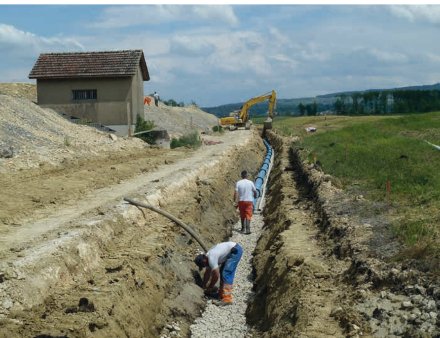
Fig. 8: Lorsqu'un projet de construction entraîne le déplacement de conduites existantes, la question du financement soulève toujours de vifs débats. Photo : Conduite de transport de WAGROM, qui a dû être reconstruite en raison de la réfection du canal de Hagneck.
